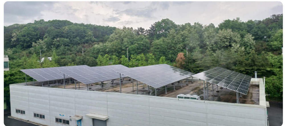
충주공장 태양광발전 설비
